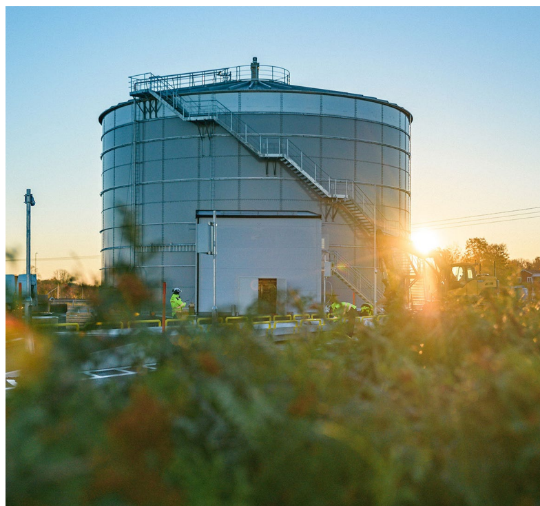
Biogasanläggning. Pressbild Tekniska verken
